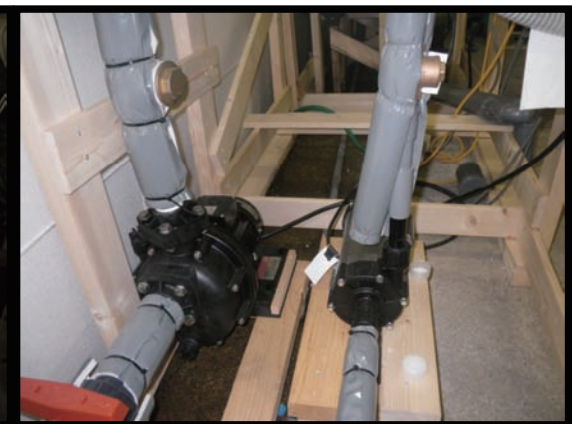
配管も断熱材で覆う
