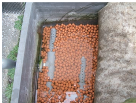
濾過槽排水用管と球形セラミック濾材(砂による目詰まり防止のため使用)
